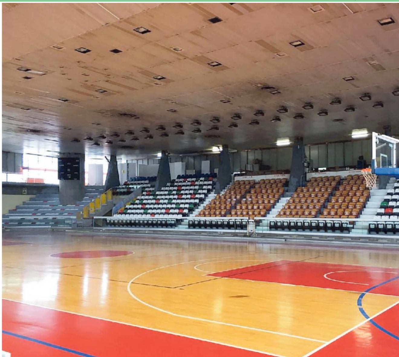
Il secondo stralcio dei lavori al pala Bigi prevede, fra l'altro, il completo rifacimento del fondo e della controsoffittatura
